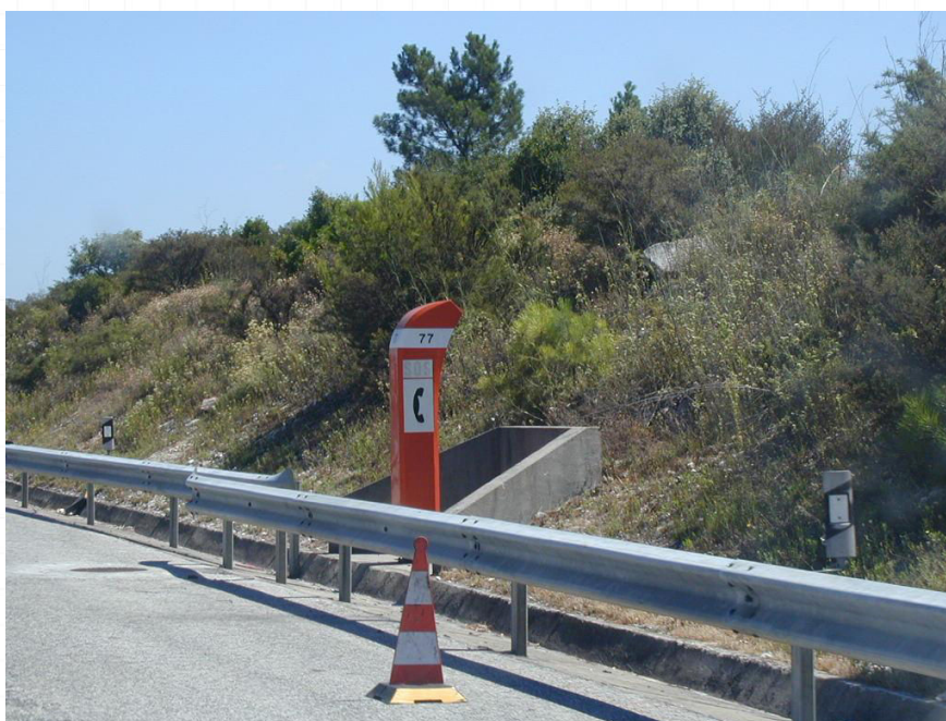
Figura 49 – Cabina telefónica de S.O.S.
